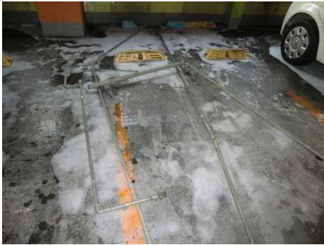
泡流出事故の例
